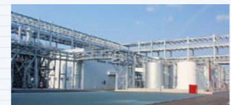
「堺ディスプレイプロダクト」内の薬液製造・リサイクルプラント
