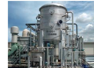
NOx回収装置
