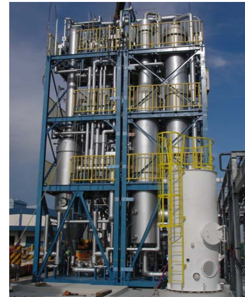
ナガセケムテックス(株) 剥離剤蒸留再生設備
