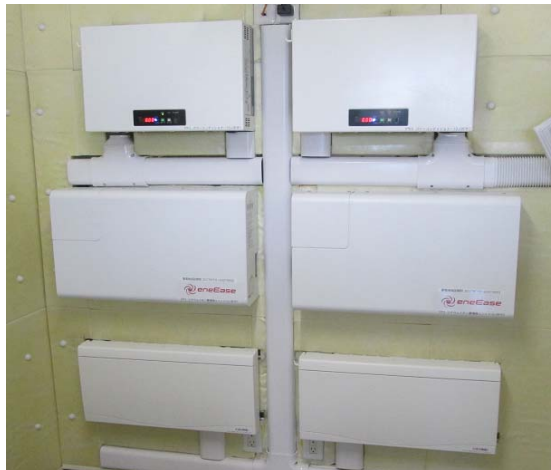
屋内に設置されたパワーコンディショナー（上）とバッテリー（下）
