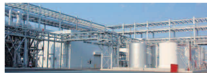
“Green Front 堺”内的药液再生工场
