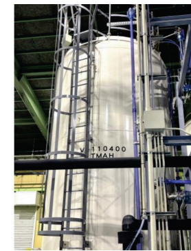
現像液の回収・再生タンク
