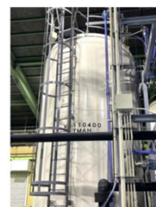
現像液の回収・再生タンク
